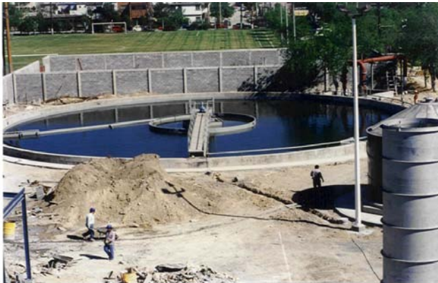
Clarificador secundario con agua de proceso en instalaciones de cerveza, planta Toluca.
