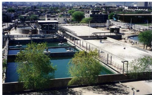
Digestores de lodos primarios y secundarios en Instalaciones de Cervecería, planta Monterrey
