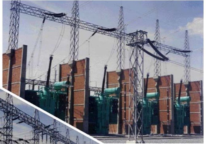
Muros cortafuego en SE Saltillo
